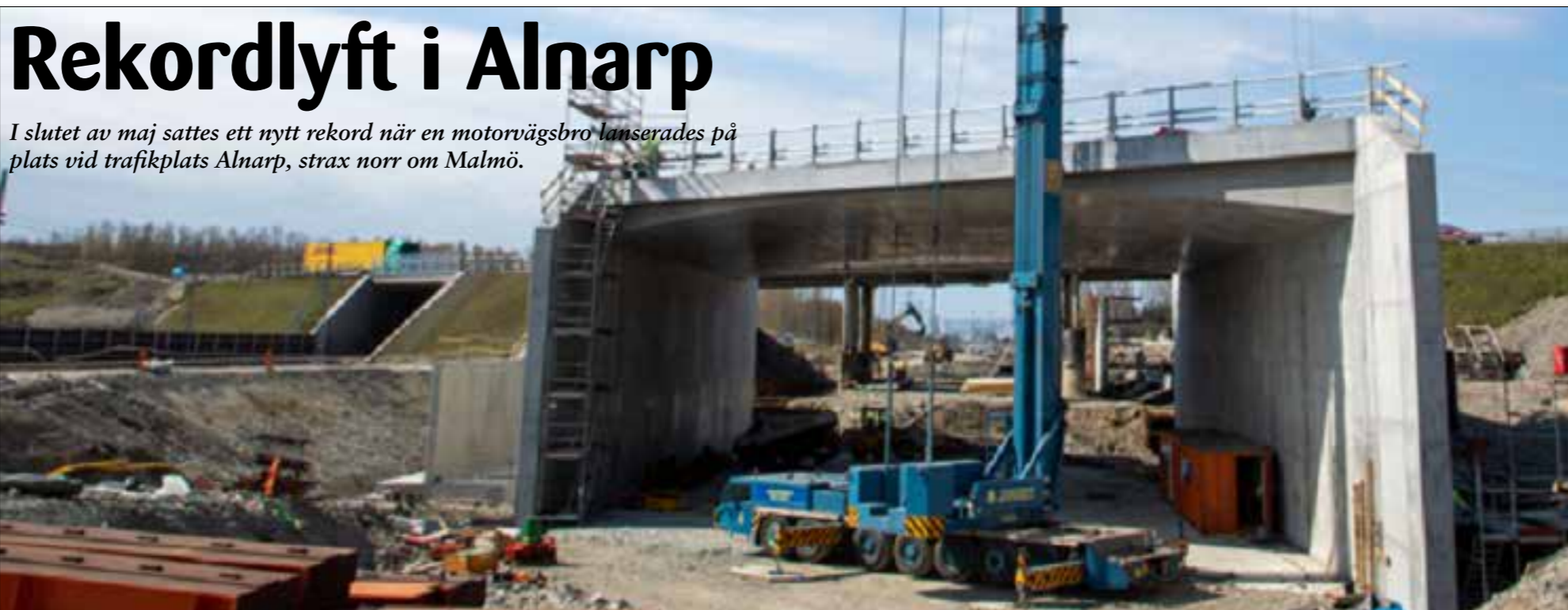
13 maj stängdes E6 vid trafikplats Alnarp och några dagar senare var det dags att lyfta och skjuta den nya motorvägsbron på plats.
