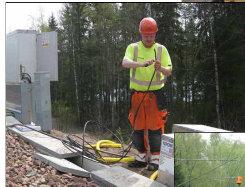
Signaltekniker Roger Andersson på Infranord kopplar in nytt skåp i Suttertjärn.
